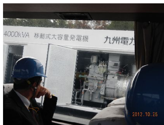
【写真④】：移動式大容量発電機
