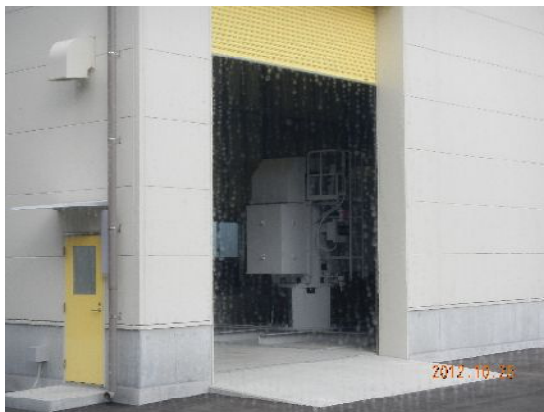
【写真⑤】：海水ポンプ用モータ予備品
